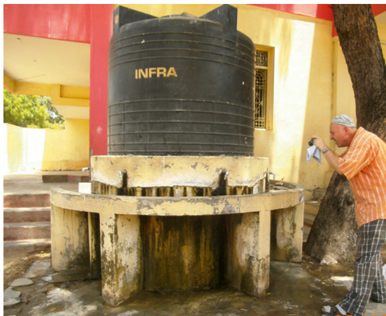
Trinkwasserbrunnen in desolatem Zustand
